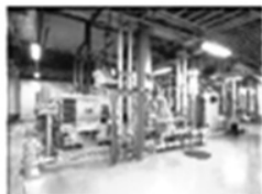
コージェネレーション設備
